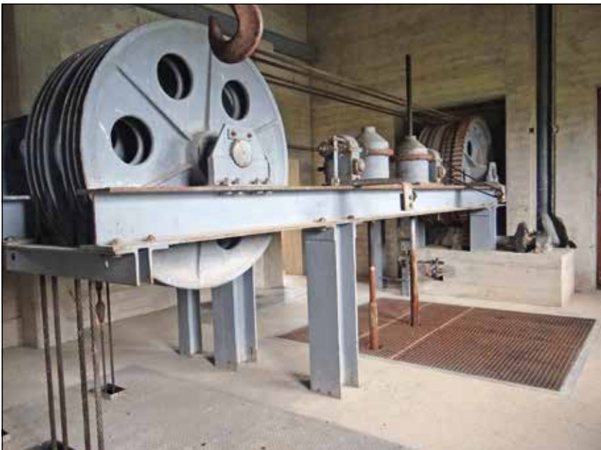
Bild 12: Unterhaupt-Torantrieb der Schleuse Piaski (Sandhof).
