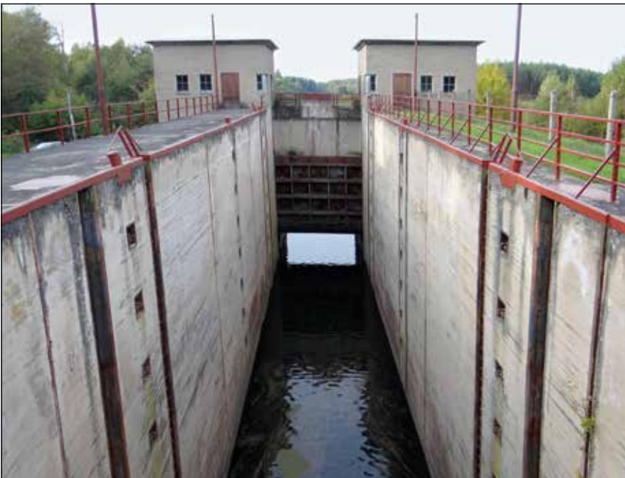
Bild 11: Kammer der Schleuse Piaski (Sandhof).
