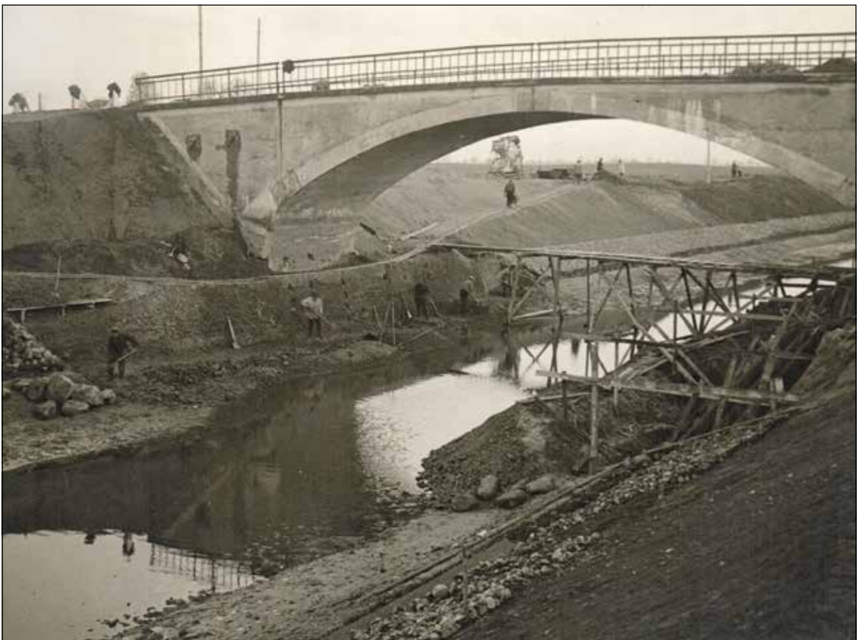
Bild 8: Erdarbeiten Los II im Auftrag des Bauamtes für den Masurischen Kanal, Insterburg. Leinpfadmauer bei km 25,75 westlich Sobrost mit Straßenbrücke Sobrost–Wandlacken.
