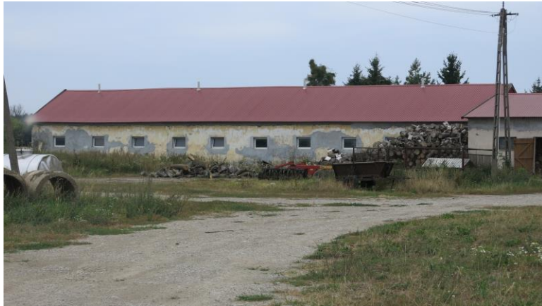
Ehemaliger Pferdestall mit neuem Dach. Der alte Putz des Mauerwerks wurde zum Teil erneuert. Rechts ein neuerer Anbau, der das Gebäude mit dem „Schafstall“ verbindet.
